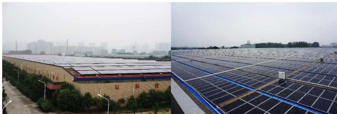
図 6-7 裕豊紡織における太陽光発電設備の導入様子
