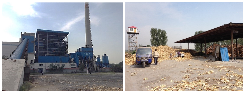
図 6-4 天潔生物発電の発電設備と原材料置き場
