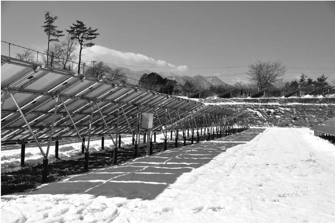
図 1 野立ての太陽光発電所の例
