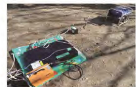
UPS(左)と発電機(右)
