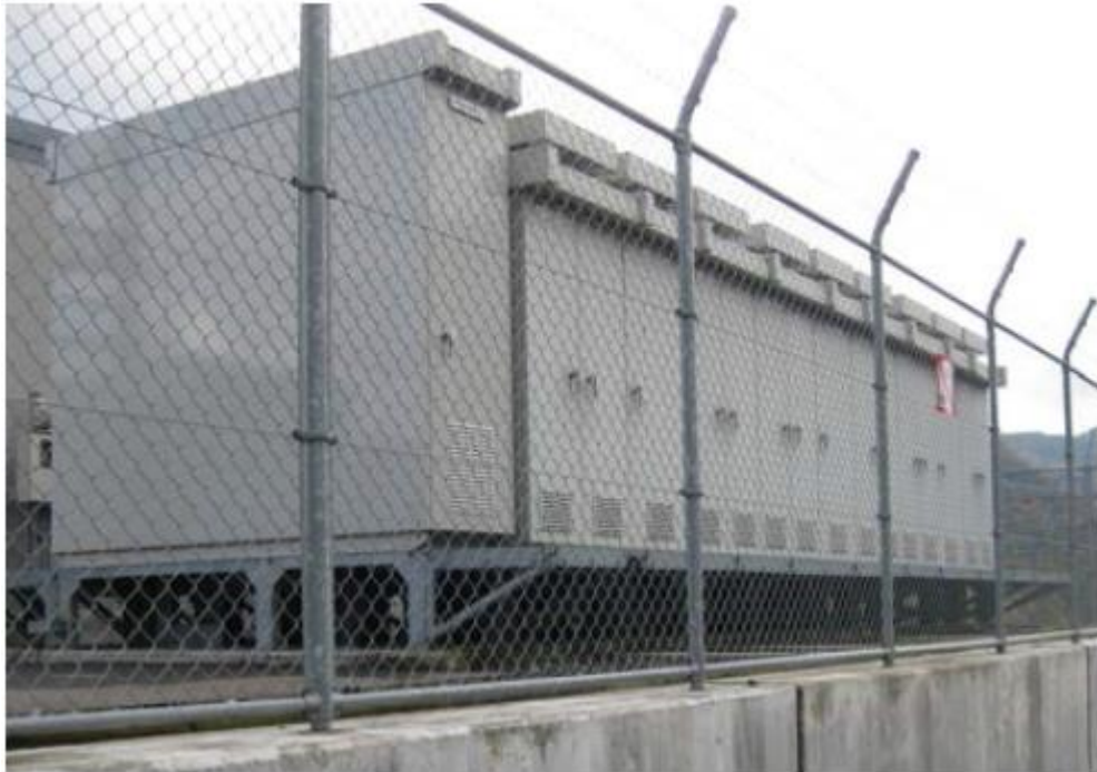
図 2-21. 新疋田蓄電装置の外観 (56)
