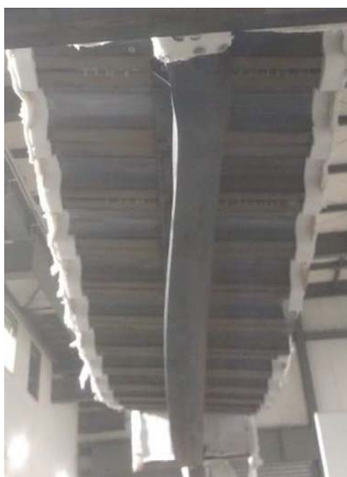
(d) 小梁の面外変形状況
