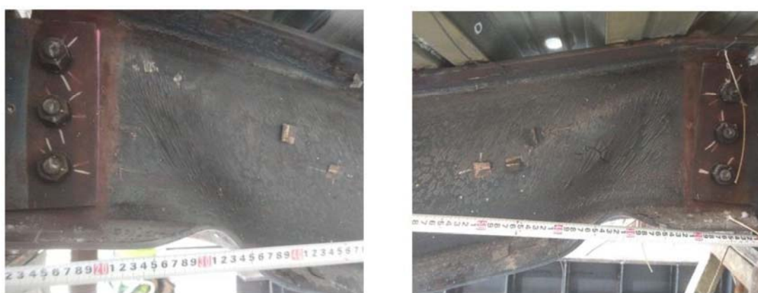
(c) 梁端の下フランジおよびウェブの局部座屈
