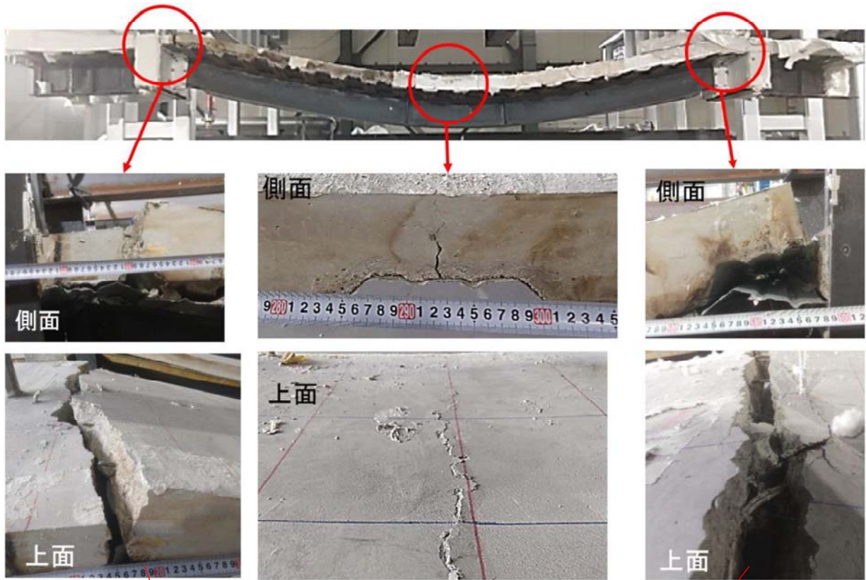
(a) たわみおよびスラブの亀裂状況
