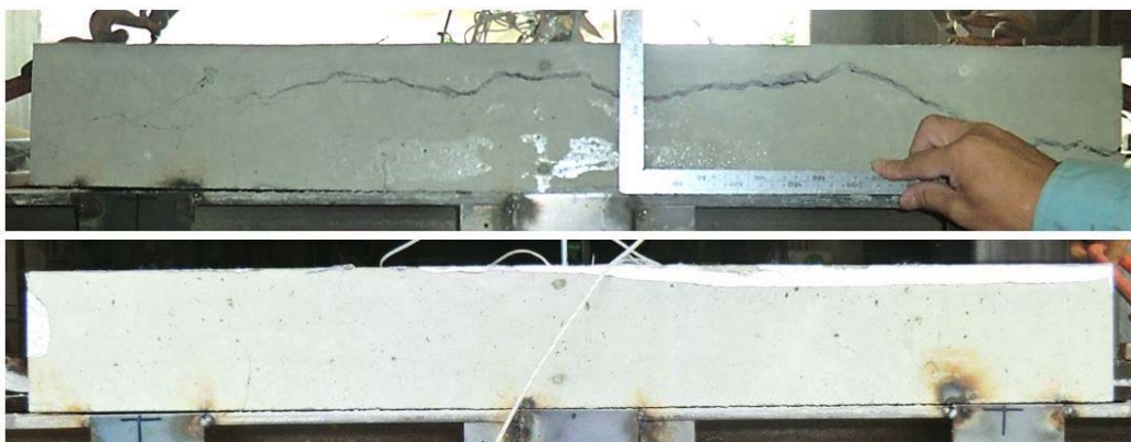
(b) 長手方向端部のスラブ側面の亀裂状況(上: 右側, 下: 左側)
