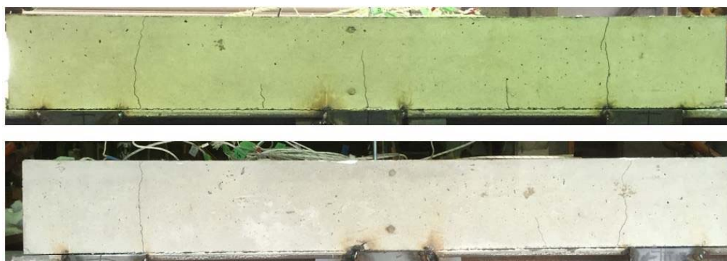
(b) 長手方向端部のスラブ側面の亀裂状況(上：右側，下：左側)
