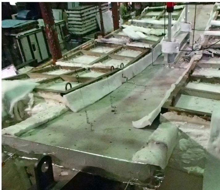
(c) 梁端付近のスラブの損傷状況(実験終了直後)
