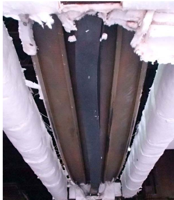
図 3.3.10 小梁の面外変形状況 (ウェブ接合梁 6UP)
