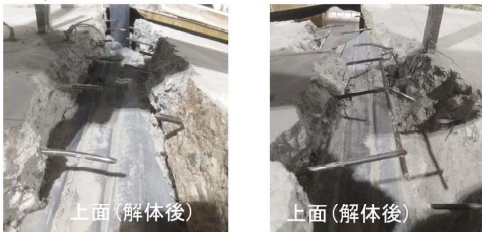
(b) 梁端の溶接金網の破断
