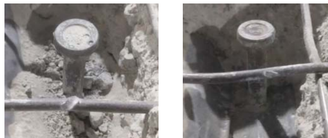
(c) 頭付きスタッドの変形状況(左: スパン中央付近, 右: 梁端付近)
