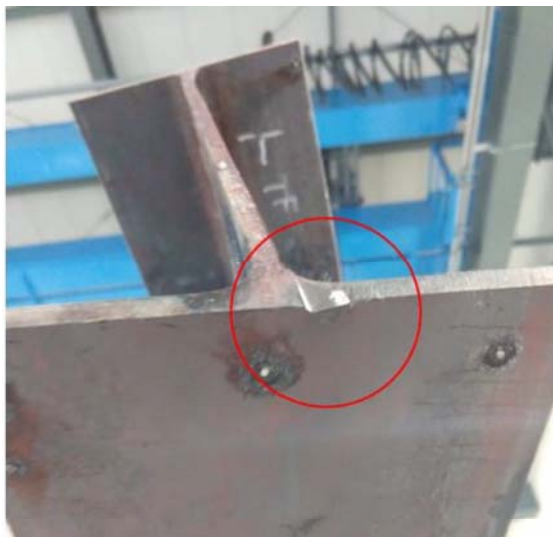
(d) 梁端の下フランジの支圧変形
