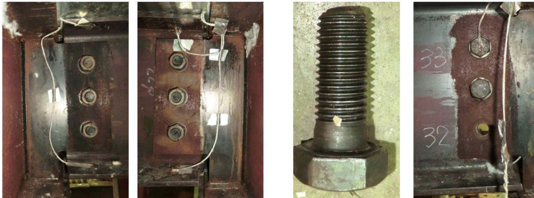
(a) 接合部の変形状況
