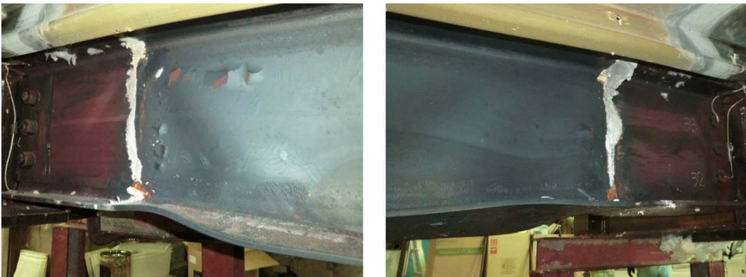
(c) 小梁端部の下フランジ局部座屈とウェブせん断座屈
