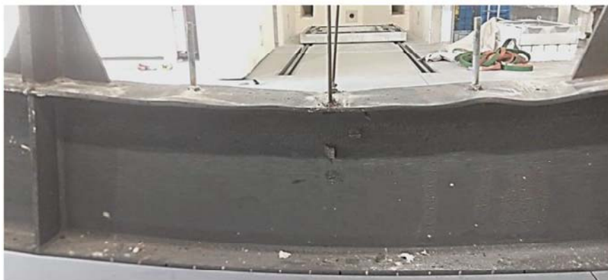
(b) スパン中央における上フランジの局部座屈
