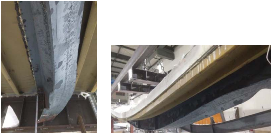
(d) 小梁の面外変形状況
