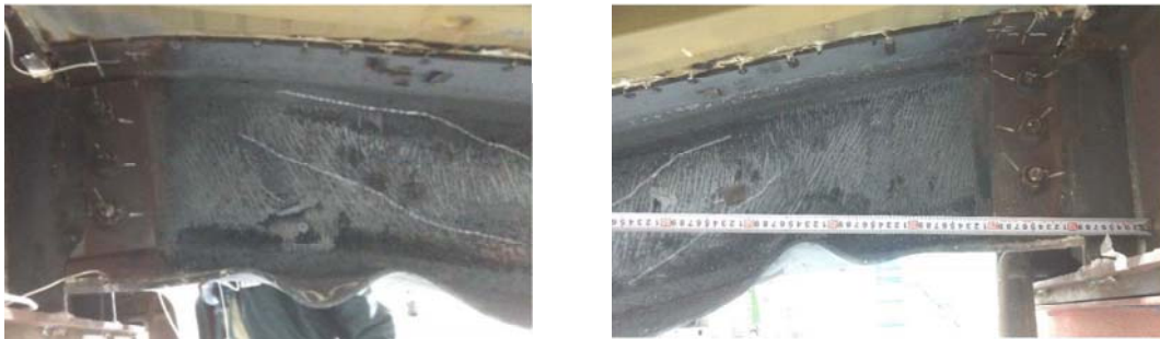
(c) 梁端の下フランジ局部座屈およびウェブのせん断座屈
