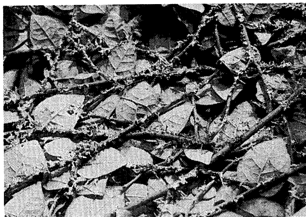
写真7 古いコンクリートブロック面から、広い面積で剥がれたオオイタビ。付着根には老化によって剥離したブロックの細片が付いている。(×1/3)
