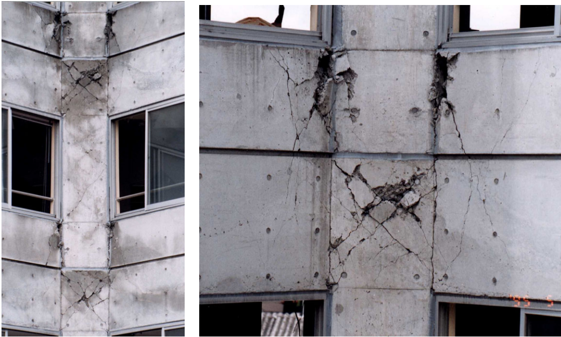
写真 2.2.1 RC造9階建ての集合住宅（ジュネス六甲）に生じた柱梁接合部の損傷 （広沢雅也先生より）
