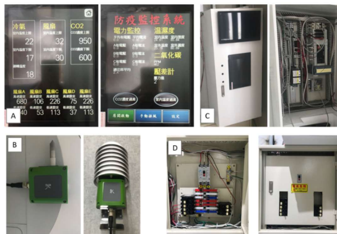
A : 自動制御盤、AC、換気、室内温湿度、CO2 B : 室内温湿度、室外温湿度 C : 制御盤 D : 電源盤 (3φ220V × 2回路 + 1φ110V × 1回路)
