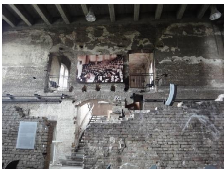
破壊された講堂跡
