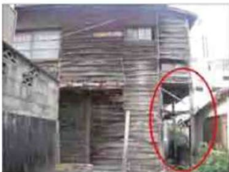
柱の数箇所に破損がある例
