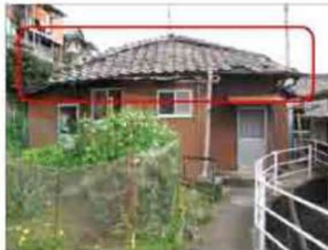
屋根に不陸がある例
