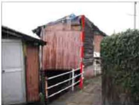
一部の柱が傾斜している例
